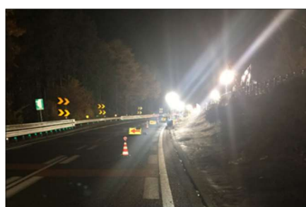
テーパー部照明の設置例
